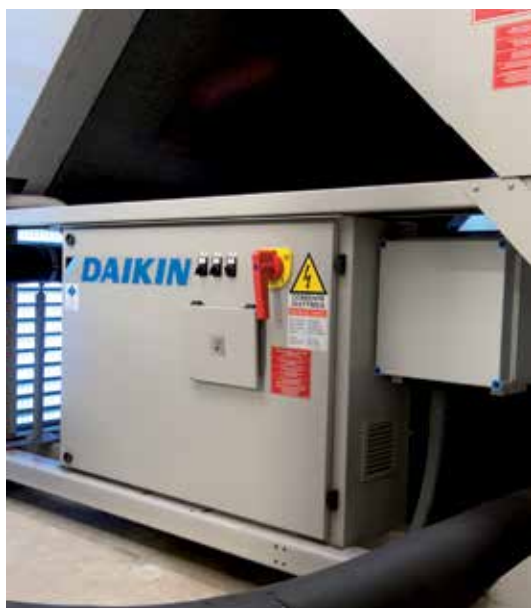
Установленная холодильная машина с воздушным охлаждением конденсатора
